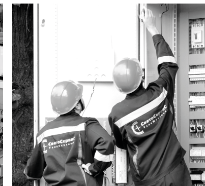
Обеспечение полного цикла работ: от разработки проекта освещения до монтажа и дальнейшей эксплуатации осветительного оборудования.
